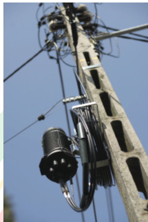
zdj. 4 Zapas światłowodu umieszczony na słupie niskiego napięcia.
